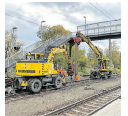
Der Ortrander Bahnhof wird barrierefrei erschlossen – bei laufendem Bahn-Betrieb. Bis Juni 2021 sollen die Arbeiten abgeschlossen sein. Foto: Mirko Sattler
