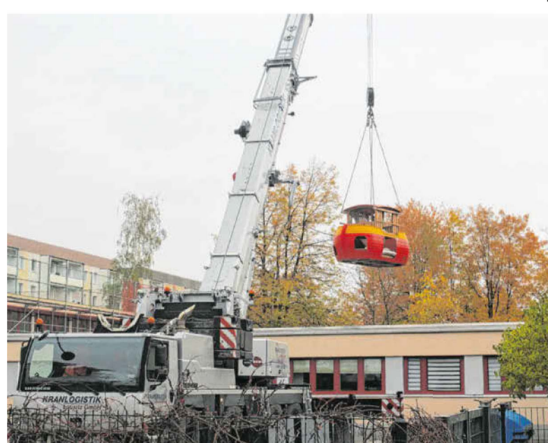
Gut zwei Tonnen wiegt das neue Außenspielgerät. Über das Kita-Dach hinweg wurde es zum Standplatz gehoben. Foto: Stadt
